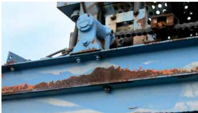
Solche Roststellen stören die Ästhetik alter Krananlagen. Bevor sie die Funktionen stören, greift Charlys Krananstreicherei ein | Bilder: Homberg
